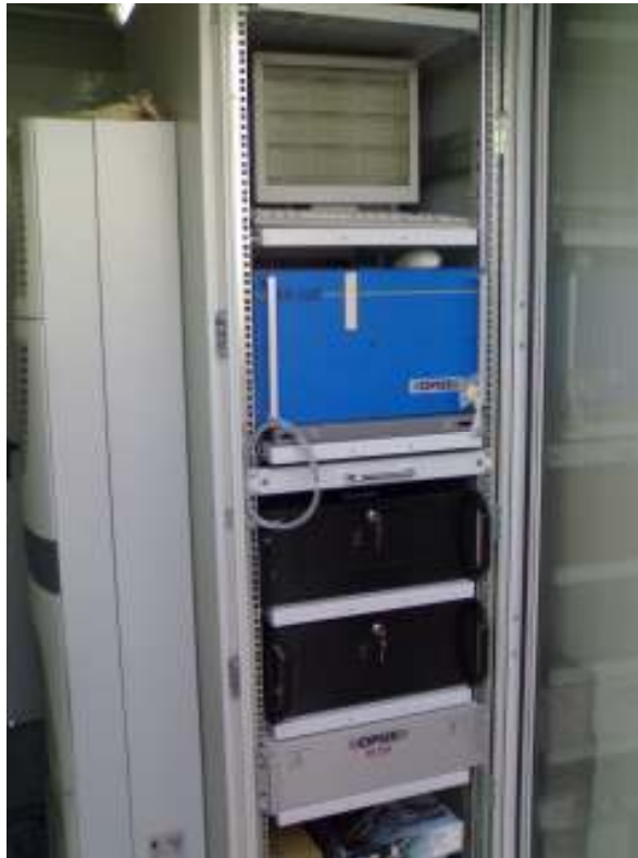
Rack per la strumentazione DOAS
